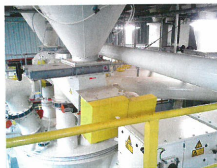
Chargenmischer sind auch Teil der Anlage.
